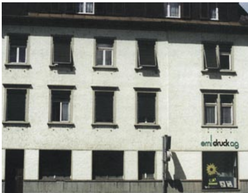
Bild 2 Fassade mit Netzen (dunkle Flecken)
